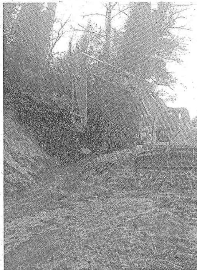
Tecnici del Consorzio al lavoro per rimuovere la frana sul fosso Agnese
